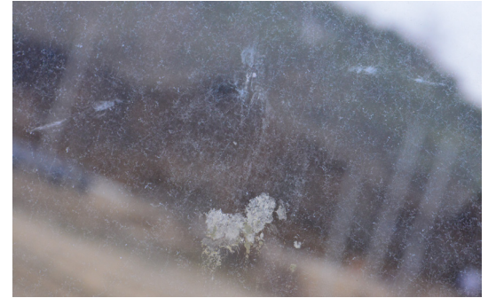
유리의 투명한 특성은 야생조류에게는 치명적이다. 멧비둘기가 도로 방음벽에 전속력으로 부딪친 결과 유리에 선명한 충돌자국을 남겼다.
